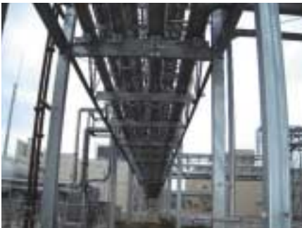
架空配管の例
