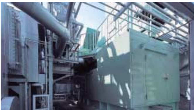
コジェネレーションシステム(村田製作所野洲事業所)
