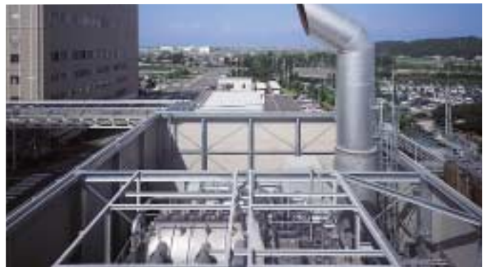
廃液減容化設備(村田製作所野洲事業所)
