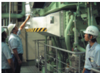
コージェネレーションシステムのガスエンジン部
