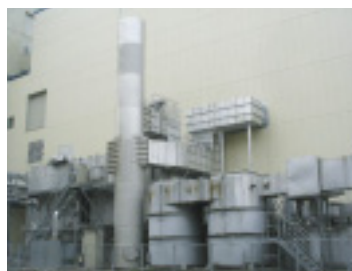
RTO(蓄熱式排ガス燃焼装置)
