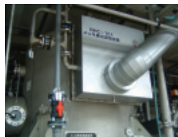
酸・アルカリ廃液の濃縮装置エバポレーター
