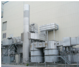
蓄熱式排ガス燃焼装置(RTO)
